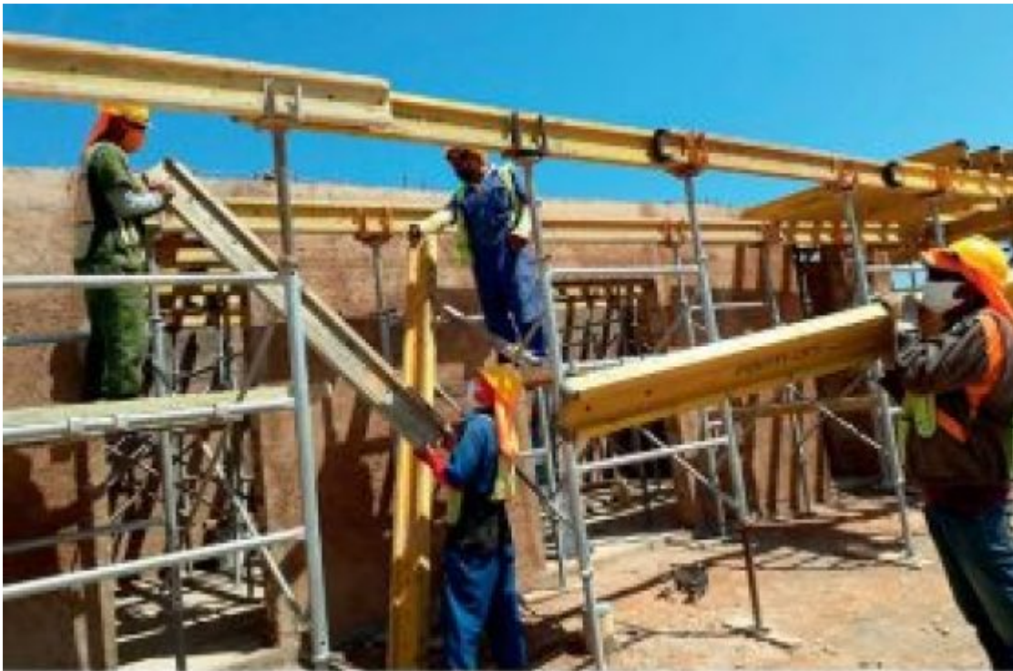
Bouwwerf voor een nieuw hotel in Varadero. Arbeidersmacht zorgt voor veilige werkomstandigheden
